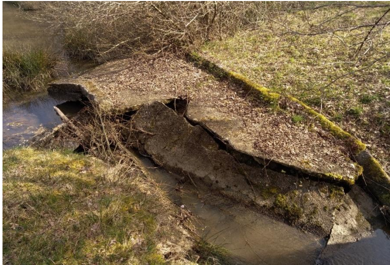
Erosion et incision significatives du bras de décharge
