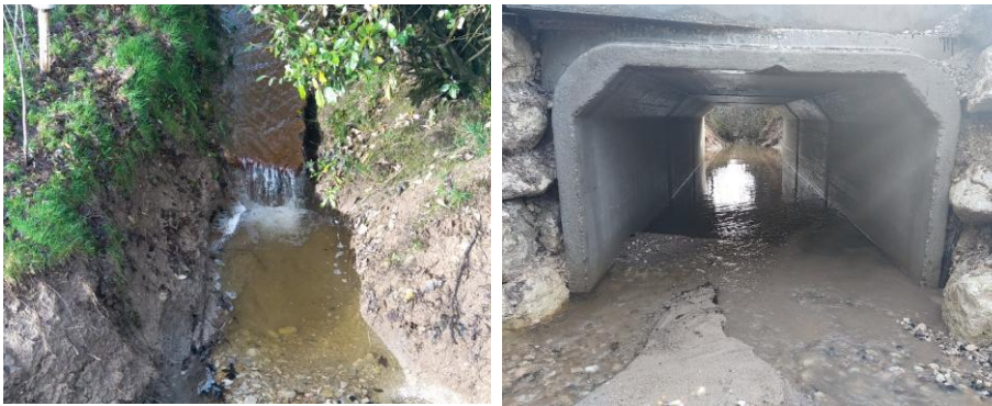
Figure 10 : Erosion en amont (à gauche) et comblement du pont cadre (à droite) le 26.02.2026
